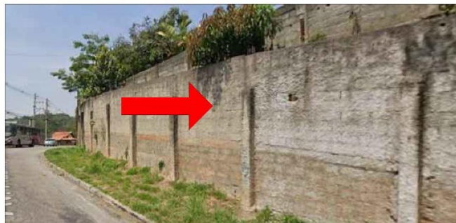
VISTA DA JUZANTE DO MURO ANTES DE COLAPSAR - Fonte GOOGLE MAPS
